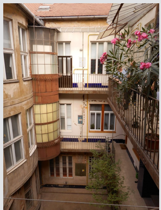
Obr. 3: Pohľad na dvorové fasády domu Rooseveltova 3. Zdroj: Krajský pamiatkový úrad Košice, autorka fotografie: Z. Labudová.
