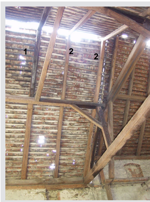
Obr. 32: Doklad požáru asi roku 1885: pohled do krovu stodoly z nově po požáru vybudovaného krovu jižních stájí (1885/1886 dendrodatace). Požár byl uhašen, použitelné části ohořelého krovu stodoly ponechány. 1 – ohořelé krokve, zvláště v horní části; mezi nimi ohořelé, dodnes zachované latě a zčernalá krytina, vše originální, 2 – dva páry vyměněných krokví, patrně již příliš ohořelých; ohořelé jsou i další prvky: oba sloupky, obě vzpěry, obě vaznice i rozpěra, celý vazný trám v popředí. Foto M. Rykl, 2012.
