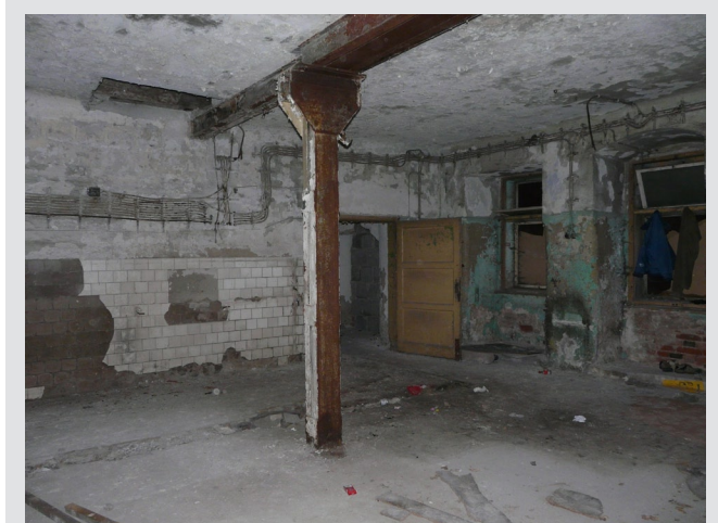
Obr. 40: Pekárna vestavěná roku 1954 do hostinského lokálu, pohled k jihozápadu. Vzadu ve stropě otvor pro (již odstraněnou) skluzavku na pytle s moukou ze skladiště – bývalého sálu – v patře. Stav se prakticky dochoval do roku 2010. Foto M. Rykl, 2011.
